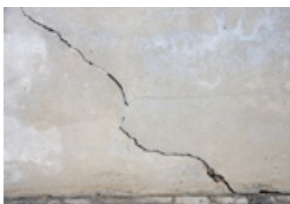
Verputzte Wand mit Rissen
