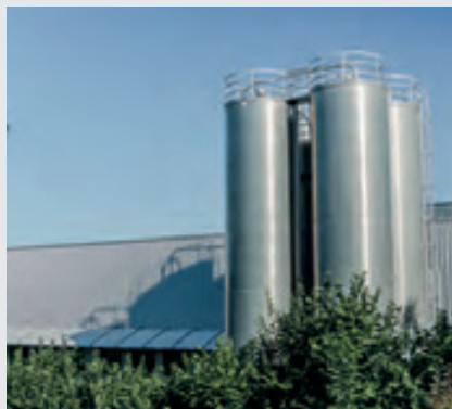
■ Silos für Rohstoffe
