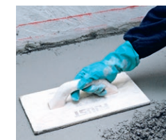
Der PCI Novoment Schnellestrich muss frisch in frisch auf die Haftbrücke aufgebracht werden
