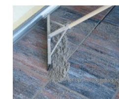
Einbringen des drainfähigen Pflasterfugenmörtels PCI Pavifix 1K Extra auf der vorgeässten Natursteinfläche
