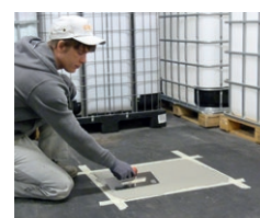
PCI Peciment 50 in einer Produktionshalle zum Lagern und Abfüllen chemischer Produkte
