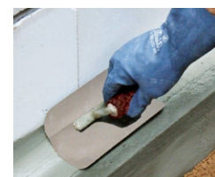
Scharfe Kanten brechen, Innenecken mit Reparaturmörtel PCI Nanocret R4 PCC / PCI Polyfix plus L als Dichtungs- / Hohlkehle ausbilden
