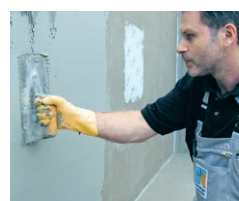
Aufbringen der schnell abbindenden, rissüberbrückenden und UV-beständigen Abdichtung PCI Barraseal Turbo in einem Wasserbecken
