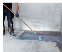
Zweimaliges Grundieren mit PCI Gisogrund 404 (im Kreuzgang sorgt für eine sichere Haftung des Bodenausgleichs auf dem Untergrund)
