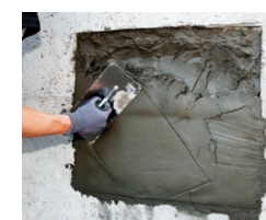
Den hochfesten Reparaturmörtel, z. B. PCI Nanocret R4 PCC, satt und hohlraumfrei händisch oder maschinell auftragen
