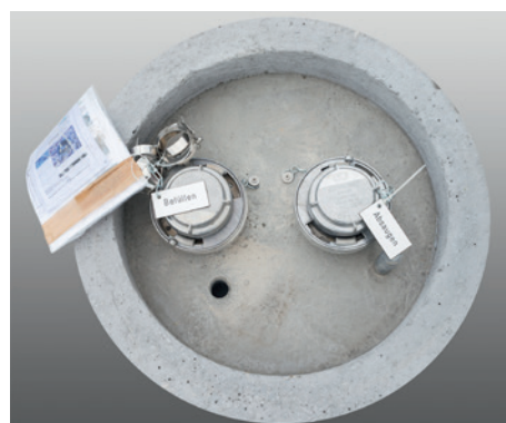
Füll- und Absaugstutzen Pelletspeicher
