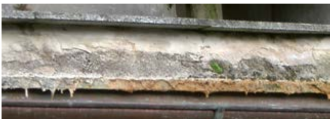
Das Ergebnis ungeschützter Estrichschichten: Schadhafte Balkonränder mit Kalkfahnen.
