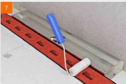
7 Beigefügtes Butyl-Abdichtungsband auf Rinne und Gefälle-Elemente kleben, faltenfrei andrücken und die Ecken überlappen.
