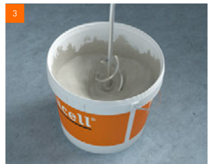
Mit geeignetem Rührgerät bei langsamer Drehzahl anmischen, bis eine homogene, klumpenfreie Nivelliermasse entsteht
