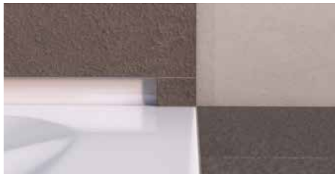
Ein kleines Fliesenstück wird hinter der Duschabtrennung aufgesetzt, um den Hohlraum zu schließen
