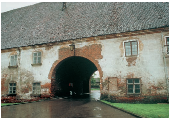
Viele historische Gebäude leiden unter feuchtem, salzhaltigem Mauerwerk
