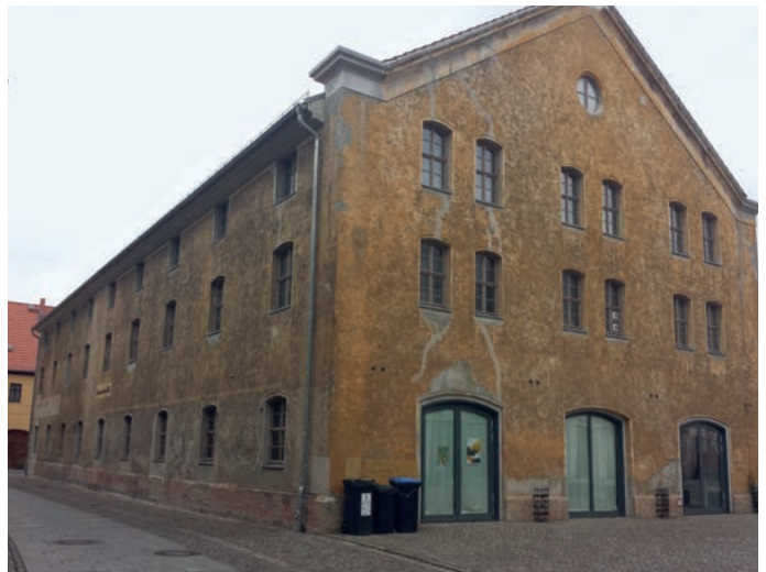
Artilleriewagenhaus in Wittenberg vor der Fassadensanierung
